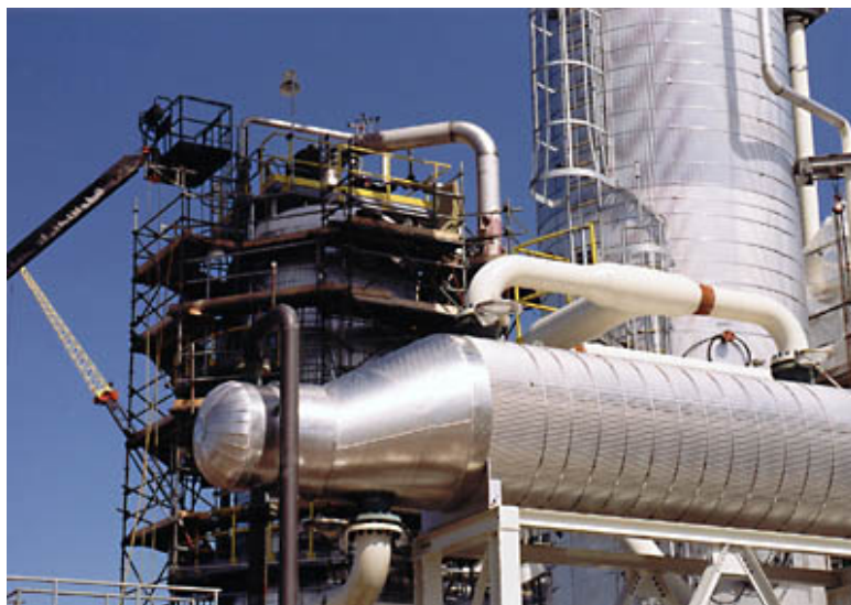
Reboiler (شکل شماره: ۲-۲-۲۷)
